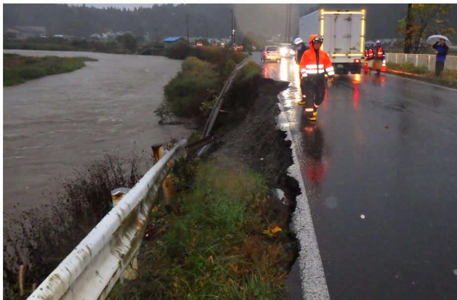
国道285号（上小阿仁村小沢田）路肩崩壊
